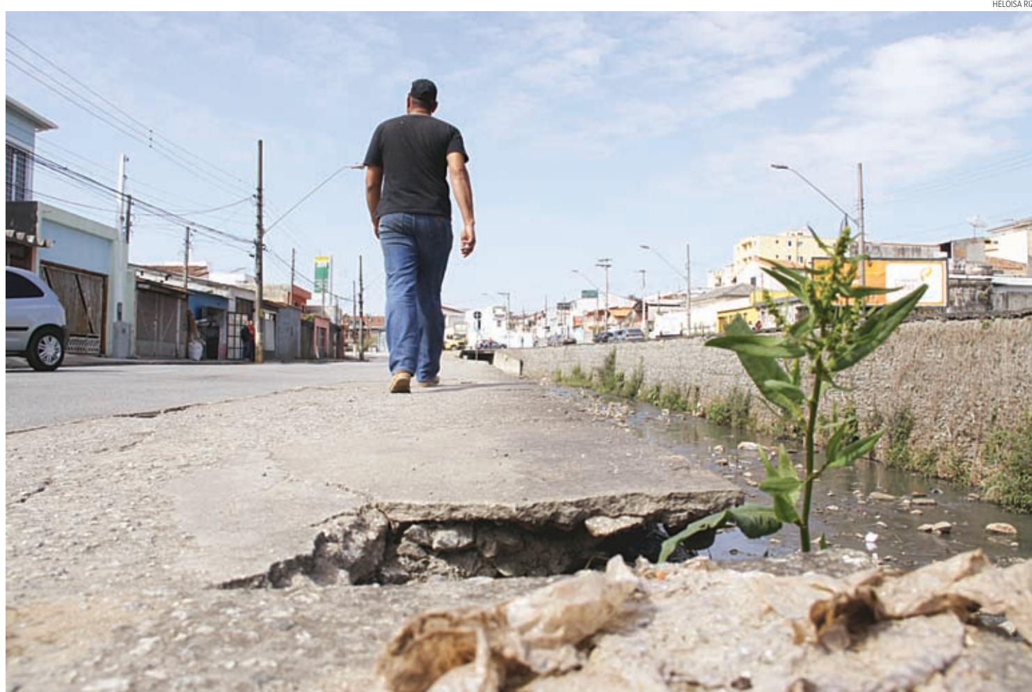
CAMINHADA DIFÍCIL Pedestres enfrentam calçadas danificadas ou em desnível em trecho da Avenida Perimetral, no Distrito de Braz Cubas
